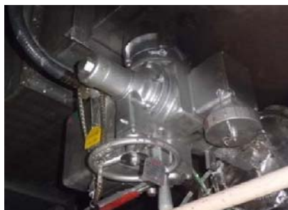
通路上部の電動弁
