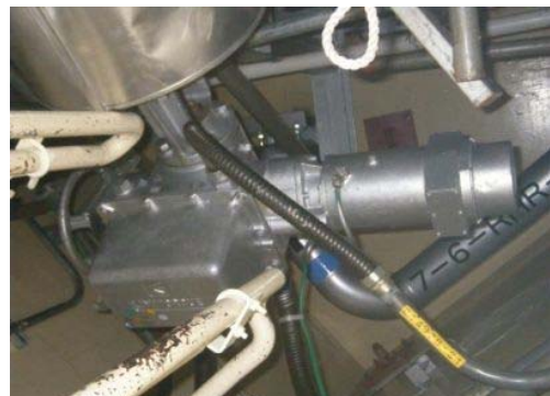
通路部上部の電動弁，電線管他
