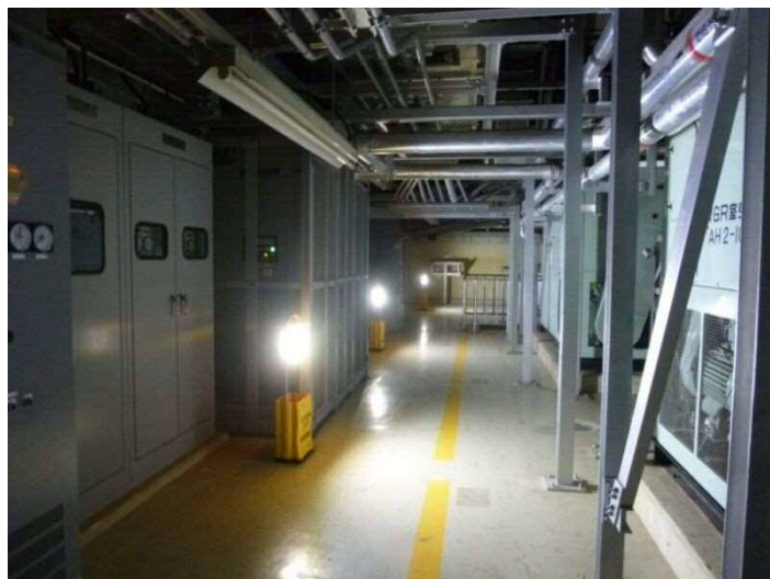
第 13 図 チェンジングエリア設置場所における 可搬型照明（S A）確認状況
