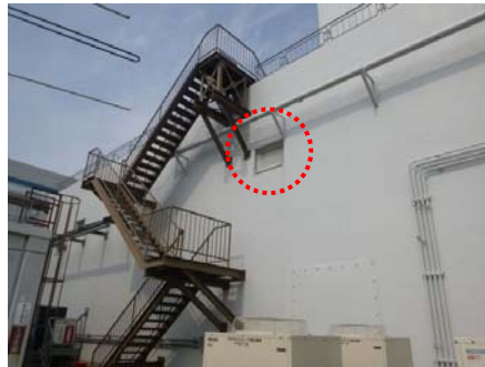
第 2 図 外気取入口（中央制御室換気空調系）
