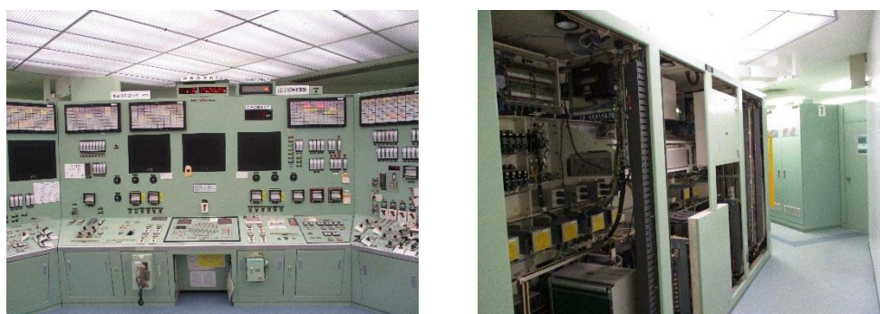
第3図 原子炉制御盤（換気口無し）
