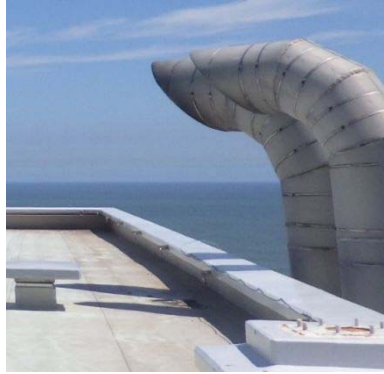
第 5 図 ディーゼル発電機排気管
