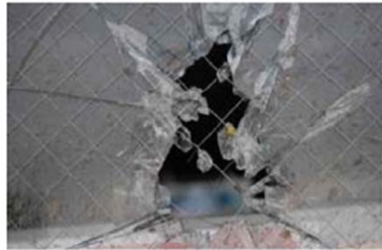
ガラスの被害状況（飛来物衝突痕）
