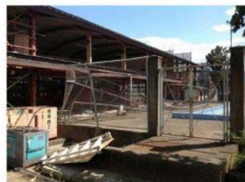
フェンスの変形（工事中の建築物）
