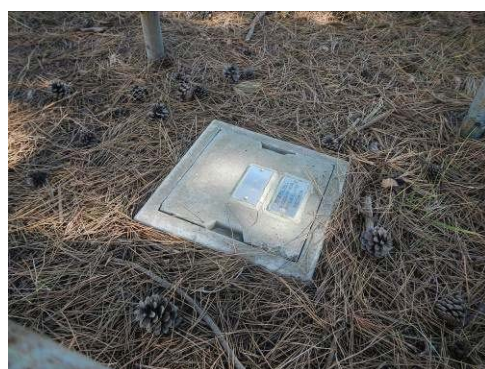
#418 コンクリート製蓋
