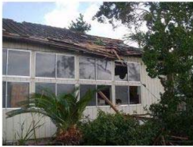
倉庫の窓ガラスと屋根の被害状況
