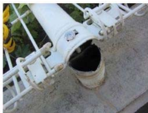
フェンス支柱部の破損
