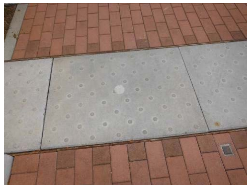
#54 コンクリート製蓋
