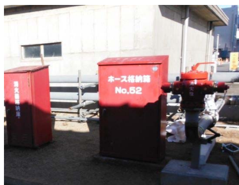
#153 消火設備格納箱
