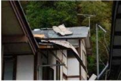
飛来物（鋼板製屋根材）の衝突
