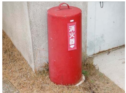
#33 消火設備格納箱
