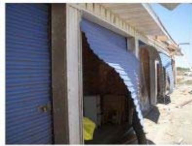
シャッターの外れ
