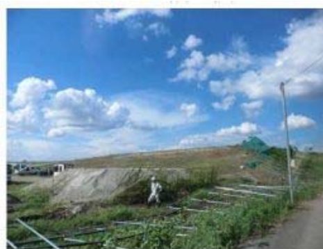
フェンスの倒壊
