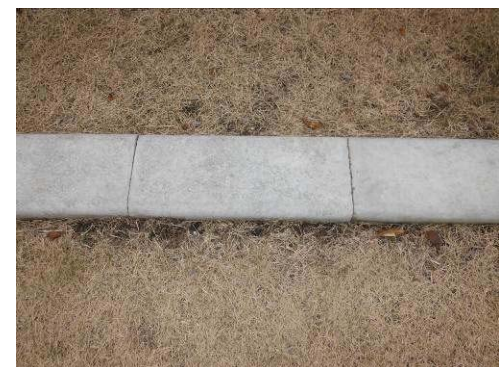
#81 コンクリート製蓋
