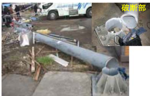
倒壊した道路標識支柱
