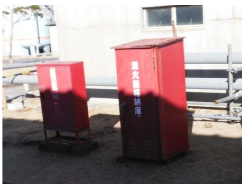
#152 消火設備格納箱
