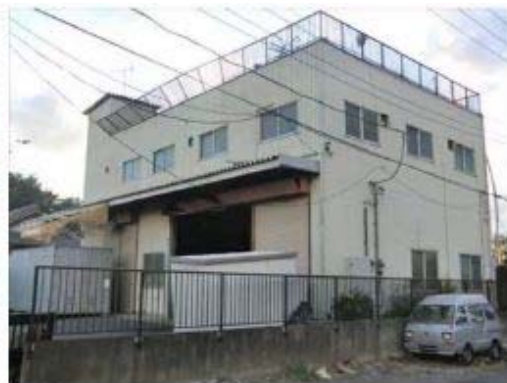
屋上フェンスの変形
