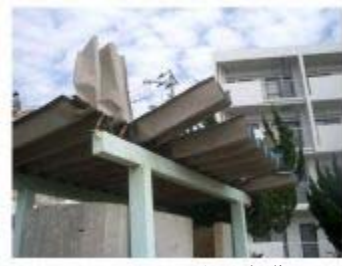
屋外トイレ屋根の損傷
