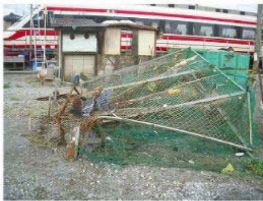
フェンスの著しい変形
