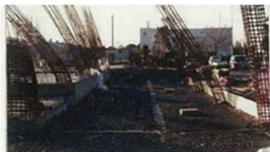
曲がった鉄筋（工事現場）
