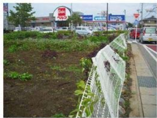
フェンスの変形
