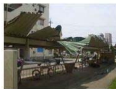
駐車場の折板屋根の著しい変形
