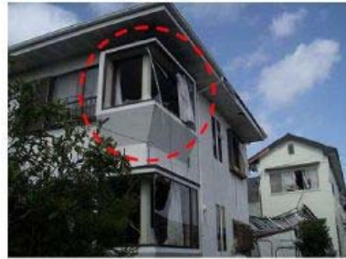
出窓部の窓ガラスの損壊
