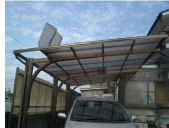
カーポート屋根の損傷
