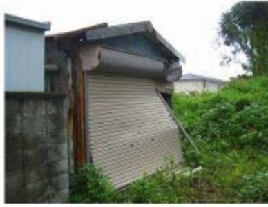
シャッターの外れ
