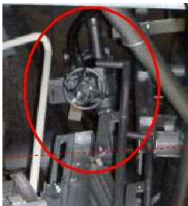
通路上部の電動弁，電線管他
