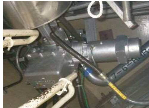
通路部上部の電動弁，電線管他
