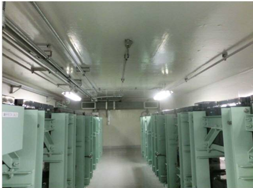
第41-1-41図 蓄電池の設置状況
