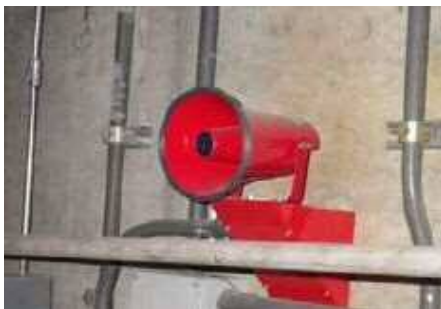
退避サイレン用音響装置
