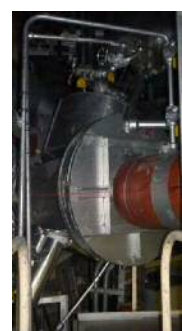
通路上部の電動弁
