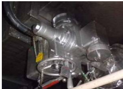
通路上部の電動弁
