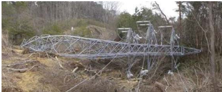
地震による斜面の崩落に伴う送電鉄塔の倒壊事例※ 2
