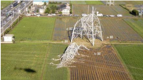
強風による送電鉄塔の倒壊事例①※ 1
