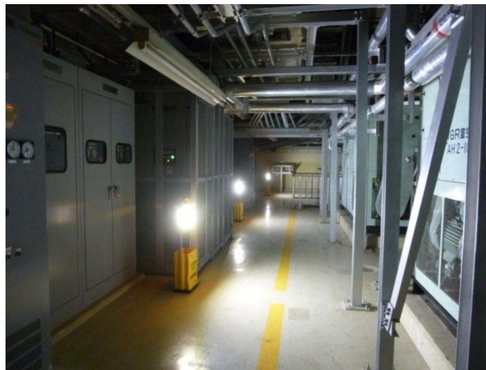
図 1-13 チェンジングエリア設置場所における可搬型照明（S A）確認状況
