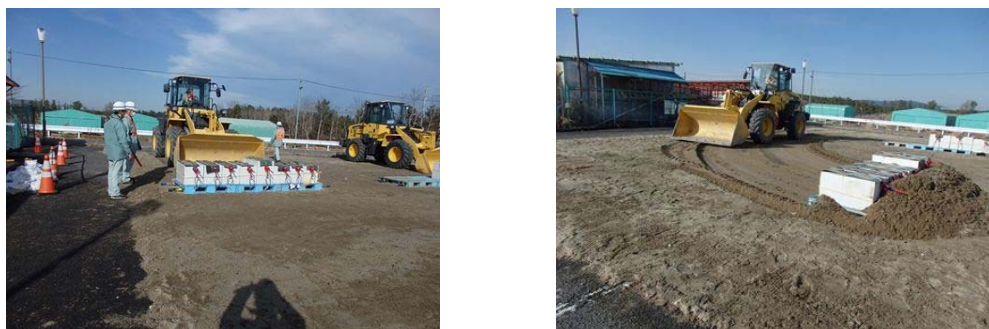
第 8-6 図 がれき撤去検証の写真
