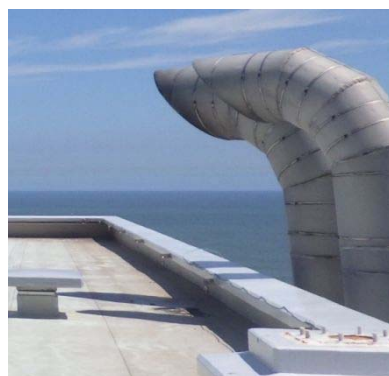
図 2-6 ディーゼル発電機 排気管
