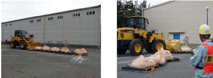
第 8-4 図 がれき撤去検証の写真
