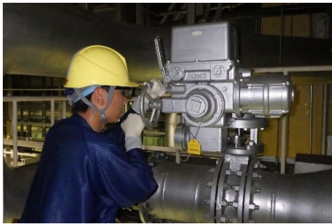
耐圧強化ベント現場操作
