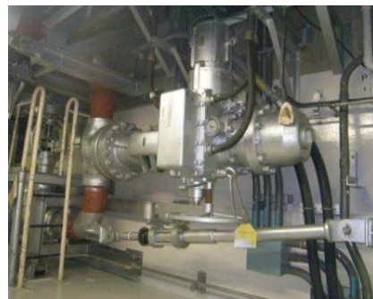
電動弁及び電線管他
