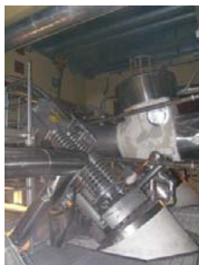
主蒸気隔離弁
