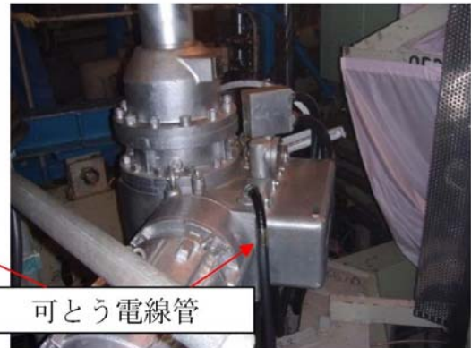
機器へのケーブル取合状況 (電動弁との取合)
