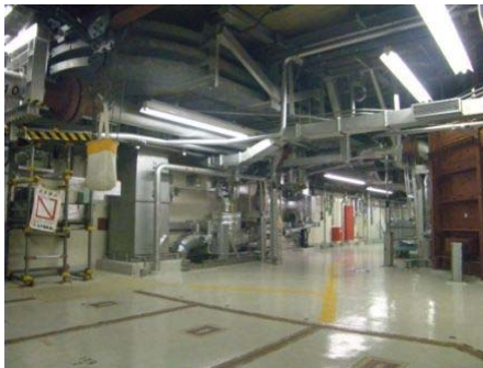
通路上の機器設置状況
