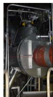
通路上部の電動弁
