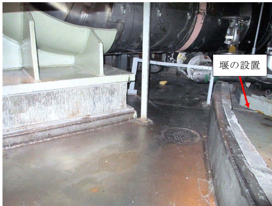
第 8-2 図 原子炉再循環系流量制御弁用の油受堰
