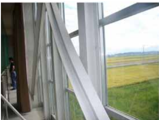
筋かい材の座屈（刈羽村）
