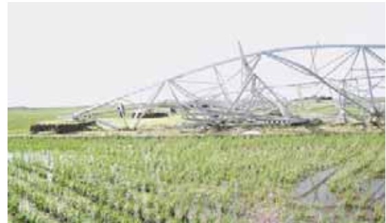
強風による鉄塔の倒壊事例②※ 1
