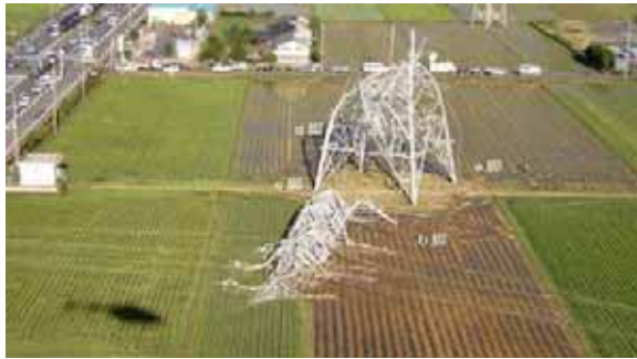
強風による鉄塔の倒壊事例①※ 1
