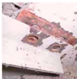
筋かい材ボルト破断
