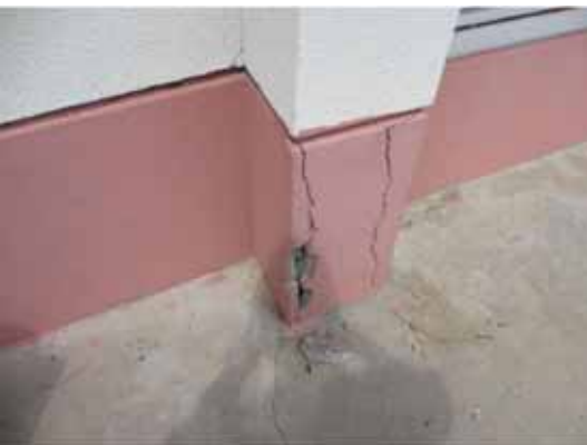
柱脚部コンクリートのひび割れ
