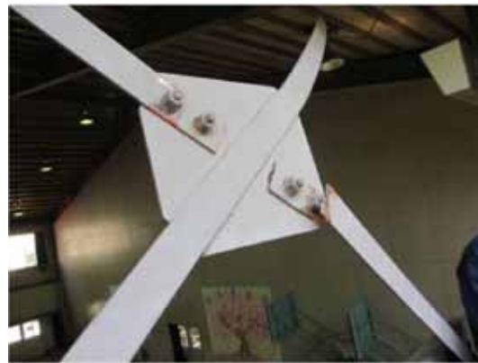
ブレース孔欠損部の破断
