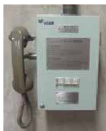
運転指令設備 (ページング)
