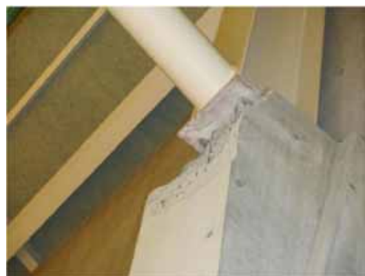
支承部コンクリート側方破壊
