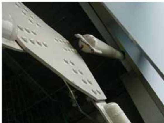
筋かい材プレート破断
