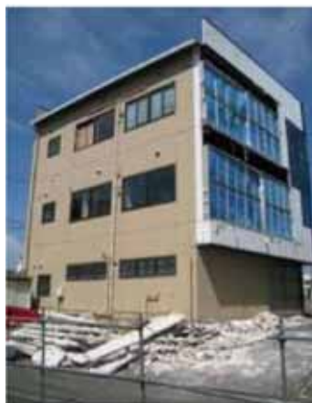
ALC パネルの脱落
