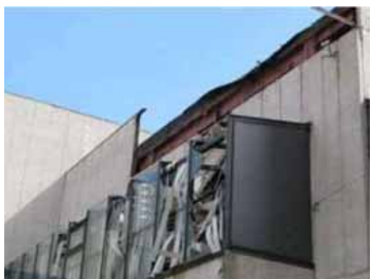
外装材の脱落，ガラス破損
