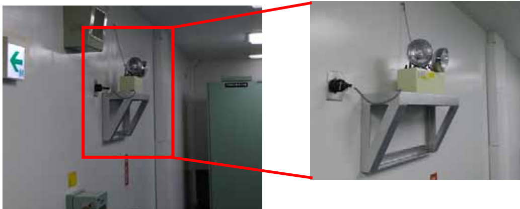
第2図 蓄電池内蔵型の照明
