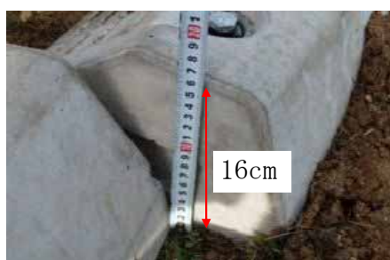
【段差復旧検証用段差】
