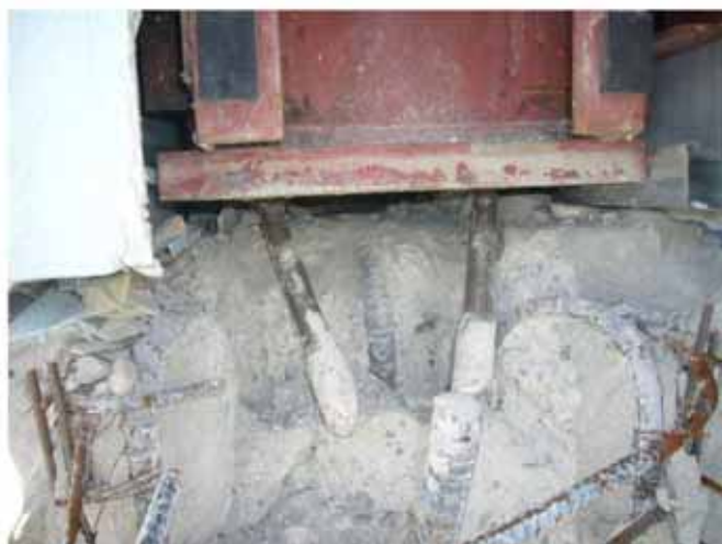
柱脚部コンクリート破壊
