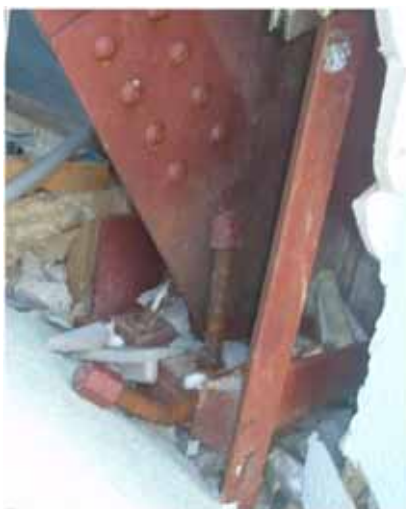
アンカーボルト引き抜け
