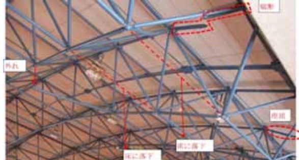
筋かい材の座屈・落下
