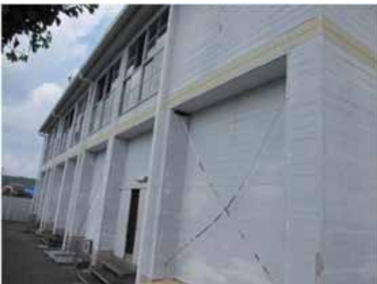
筋かい材の変形
