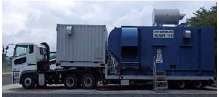
常設代替交流電源装置
