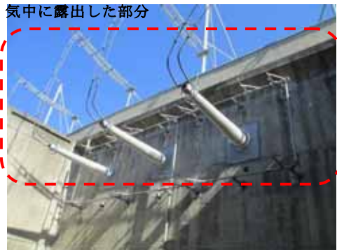
i) 275kV 送電線引込部
