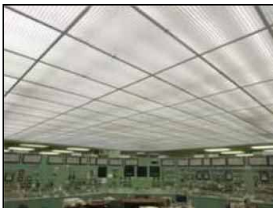
（通常点灯状態）
