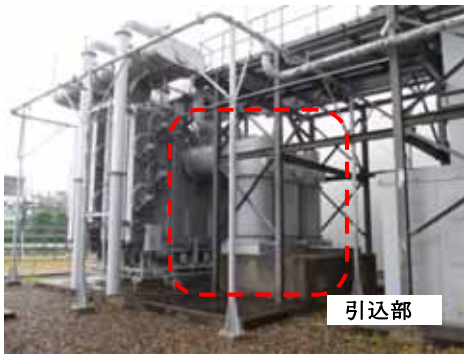
iii) 起動変圧器 (露出部無)
