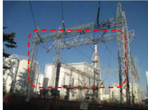
ii) 154kV 送電線引込部 (イメージ図) 気中に露出した部分
