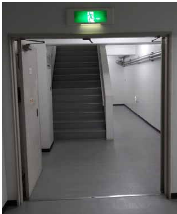
避難口誘導灯
