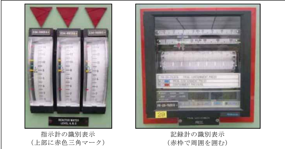
第 2.4.1-6 図 重要指示計等の識別表示 (例)
