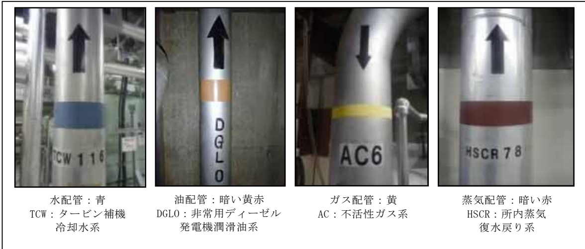
第 2.4.2-2 図 配管の識別管理（例）
