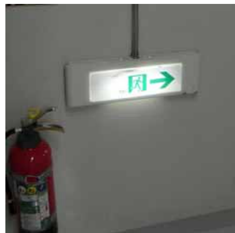
通路誘導灯（廊下・通路）
