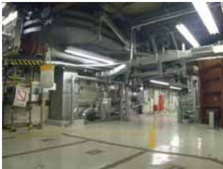
通路上の機器設置状況
