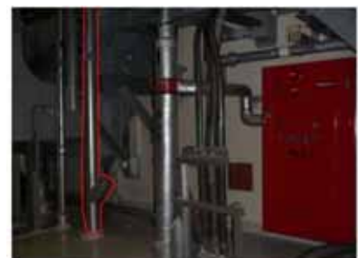
配管の設置例
