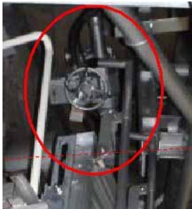
通路上部の電動弁，電線管他
