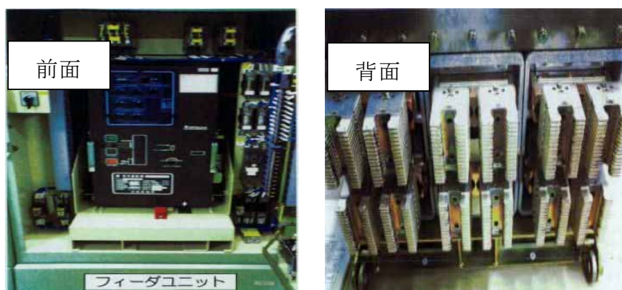
第1-14図 気中遮断器外観
