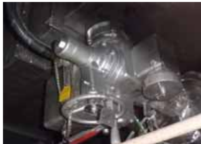
通路上部の電動弁
