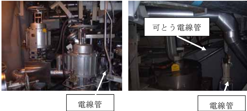
第 8-12 図 原子炉格納容器内の機器等の設置状況
