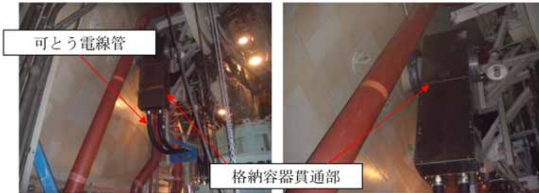
機器へのケーブル取合状況 (格納容器貫通部と電線管との取合)
