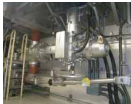
電動弁及び電線管他
