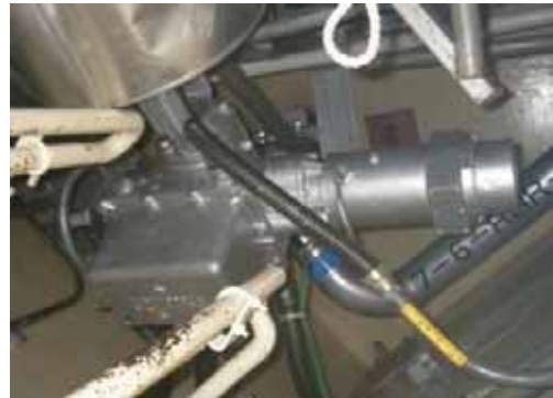
通路部上部の電動弁，電線管他
