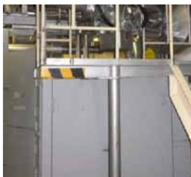
電動弁(遮蔽内に設置)
