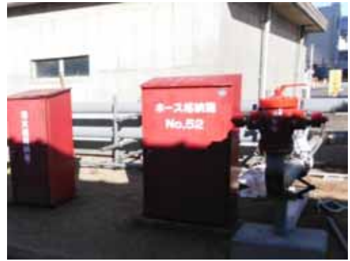
#153 消火設備格納箱
