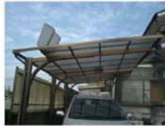
カーポート屋根の損傷
