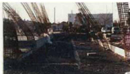
曲がった鉄筋 (工事現場)
