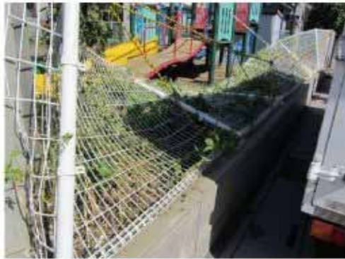
フェンスの変形
