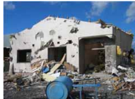
飛来物による被害を受けた建物
