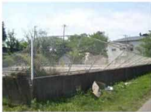
フェンスの変形
