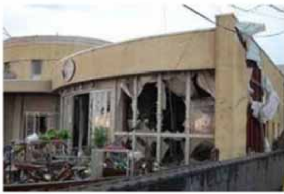
店舗の窓ガラスの被害状況
