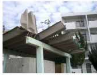
屋外トイレ屋根の損傷
