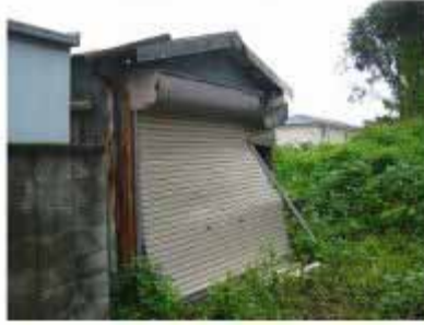
シャッターの外れ
