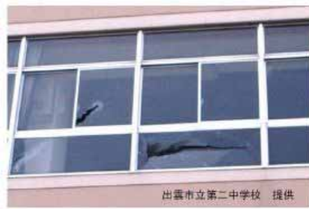
体育館窓ガラスの損壊
