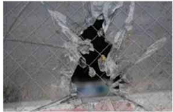
ガラスの被害状況（飛来物衝突痕）
