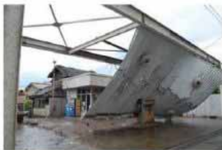
ガソリンスタンドの折板屋根の脱落
