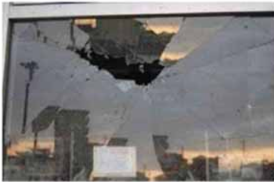
ガラスの被害状況（飛来物衝突痕）
