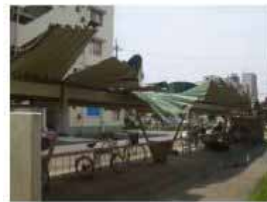
駐車場の折板屋根の著しい変形
