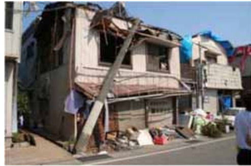
倒壊電柱に直撃された家屋
