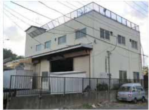
屋上フェンスの変形
