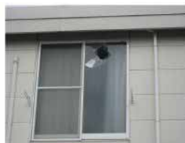
窓ガラスの飛来物衝突痕
