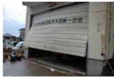
消防団施設のシャッターの変形
