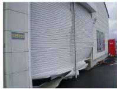
シャッターの変形
