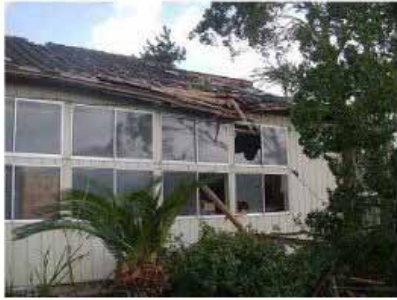
倉庫の窓ガラスと屋根の被害状況
