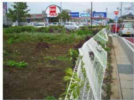
フェンスの変形
