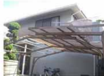
カーポートの被害
