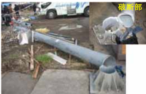
倒壊した道路標識支柱
