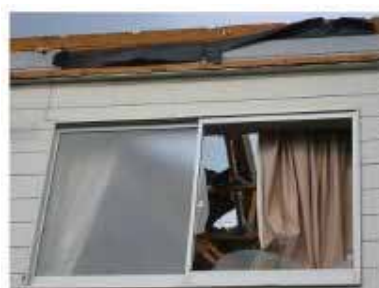
窓ガラスの損壊
