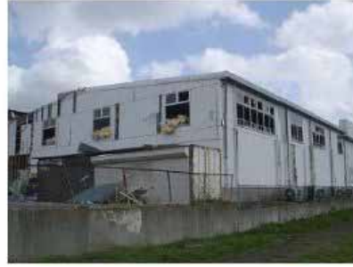
窓ガラスの損壊
