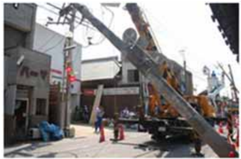
倒れた電柱(復旧作業時)
