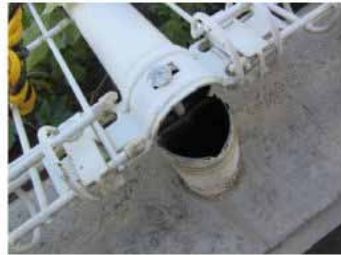
フェンス支柱部の破損
