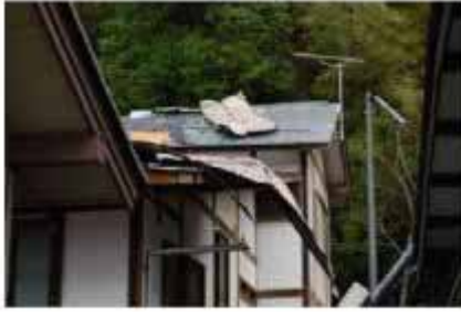
飛来物（鋼板製屋根材）の衝突
