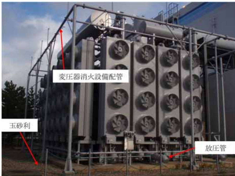
第4図 変圧器外観
