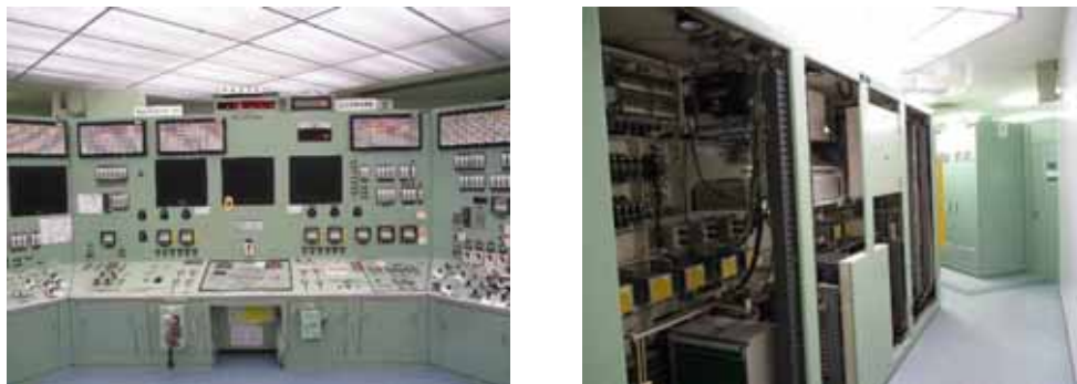
第3図 原子炉制御盤（換気口無し）
