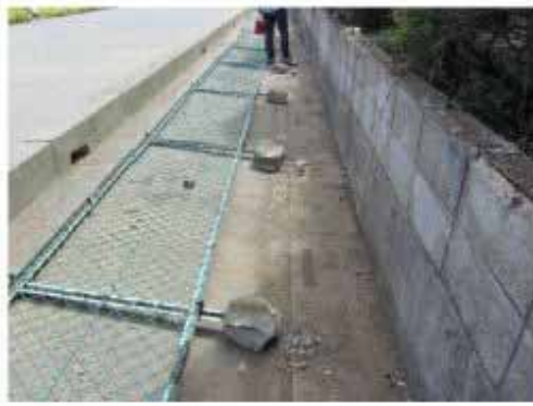
フェンスの倒壊
