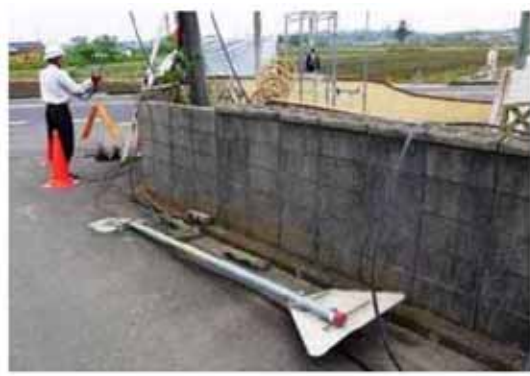
道路標識の倒壊
