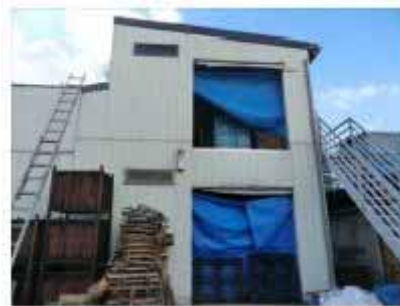
シャッターの外れ
