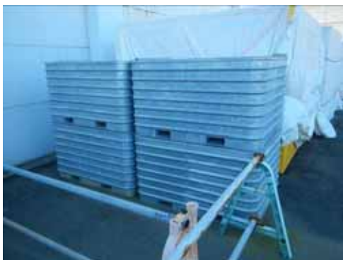
#436 鋼製ボックス
