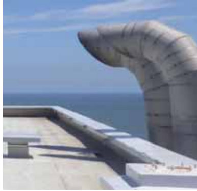
第 5 図 ディーゼル発電機排気管
