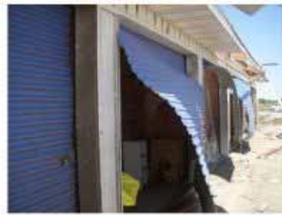
シャッターの外れ
