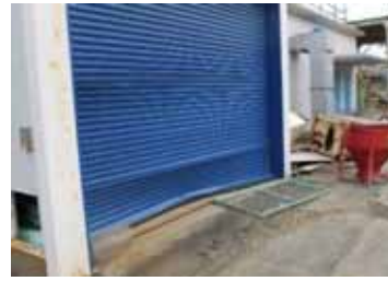
② メンテナンスセンター（S造） シャッター変形
