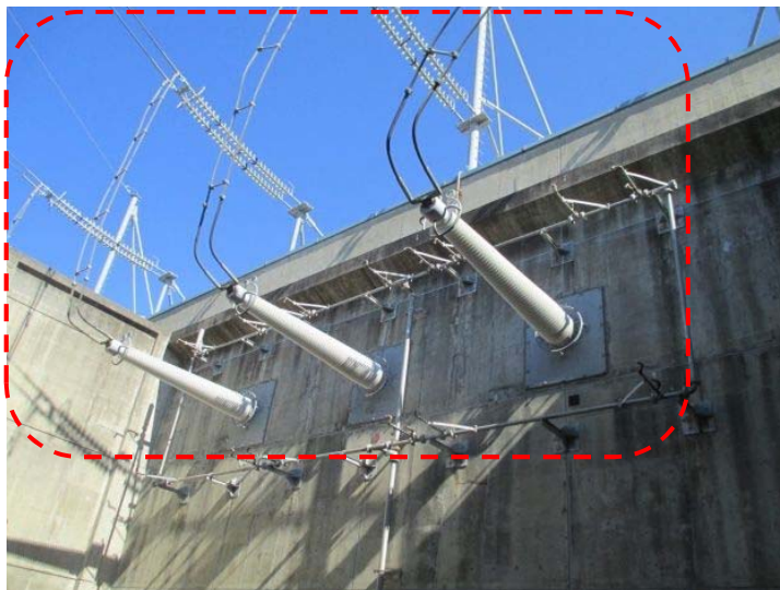
275kV 送電線引込部（イメージ）
