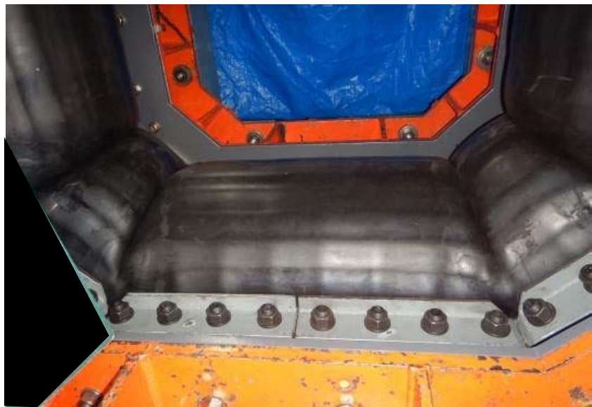
底版 (漏えいなし)
