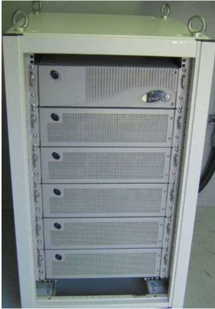
無停電電源装置
