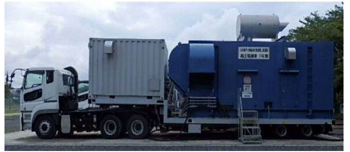
常設代替交流電源設備
