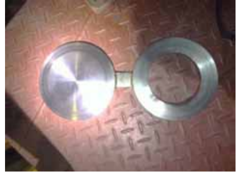
連絡配管閉止フランジ
