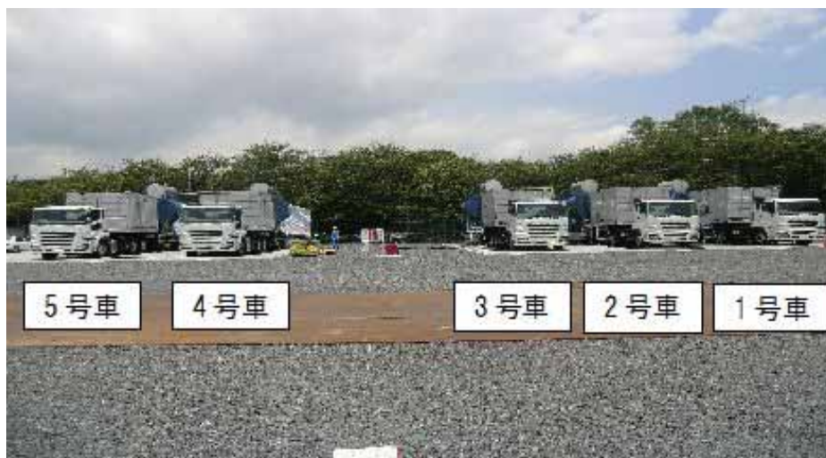
常設代替高圧電源装置（イメージ）
