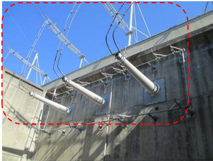
275kV 送電線引込部（イメージ）
