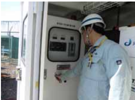
可搬型窒素供給装置（小型）起動
