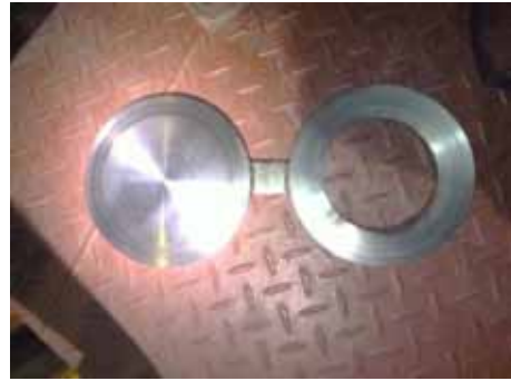
連絡配管閉止フランジ
