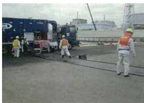
夜間での送水訓練（ポンプ設置）
