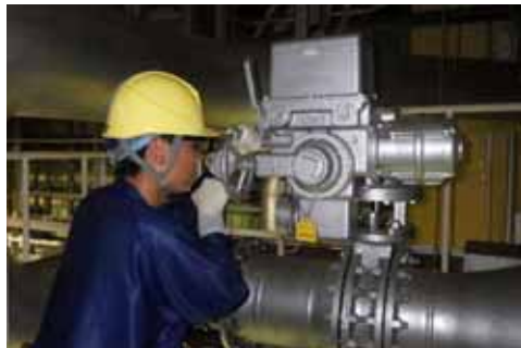
耐圧強化ベント現場操作
