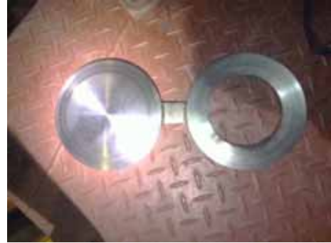
連絡配管閉止フランジ
