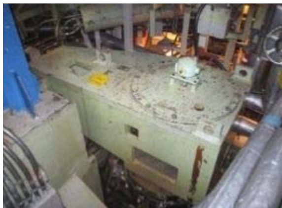
第 4 図 原子炉再循環ポンプ用電動機
