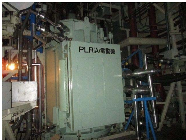
第 5 図 原子炉再循環ポンプ用電動機
