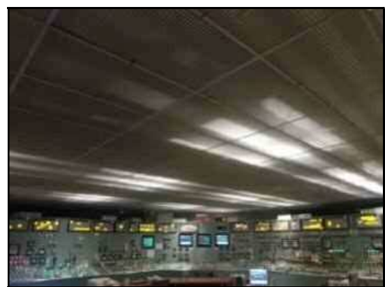
（直流非常灯点灯状態）
