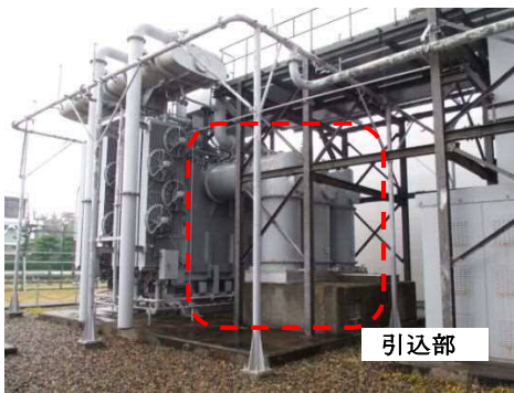
iii) 起動変圧器 (露出部無)
