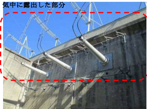
i) 275kV 送電線引込部
