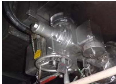
通路上部の電動弁
