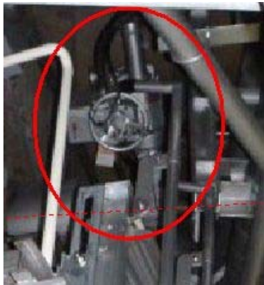
通路上部の電動弁，電線管他
