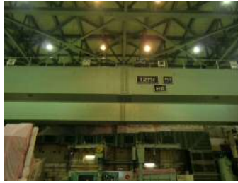
原子炉建屋クレーン
