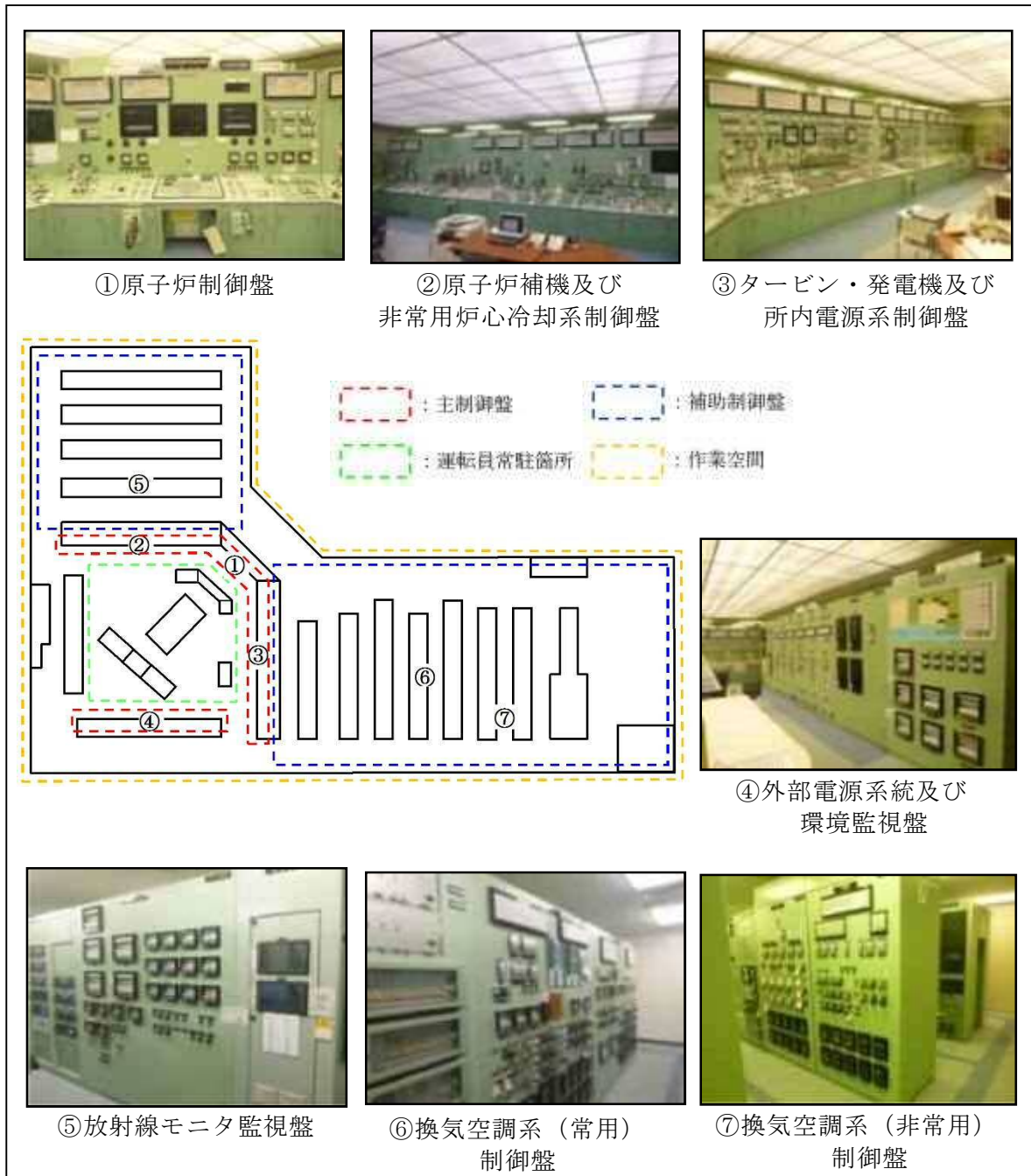
第 2.4.1-1 図 中央制御室の制御盤配置
