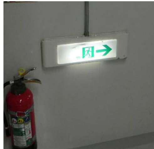
通路誘導灯（廊下・通路）
