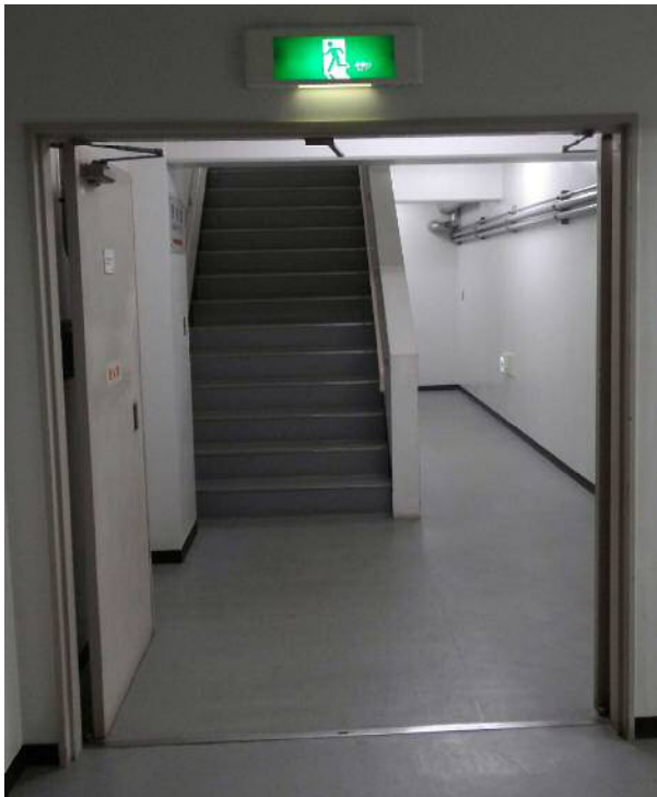
避難口誘導灯
