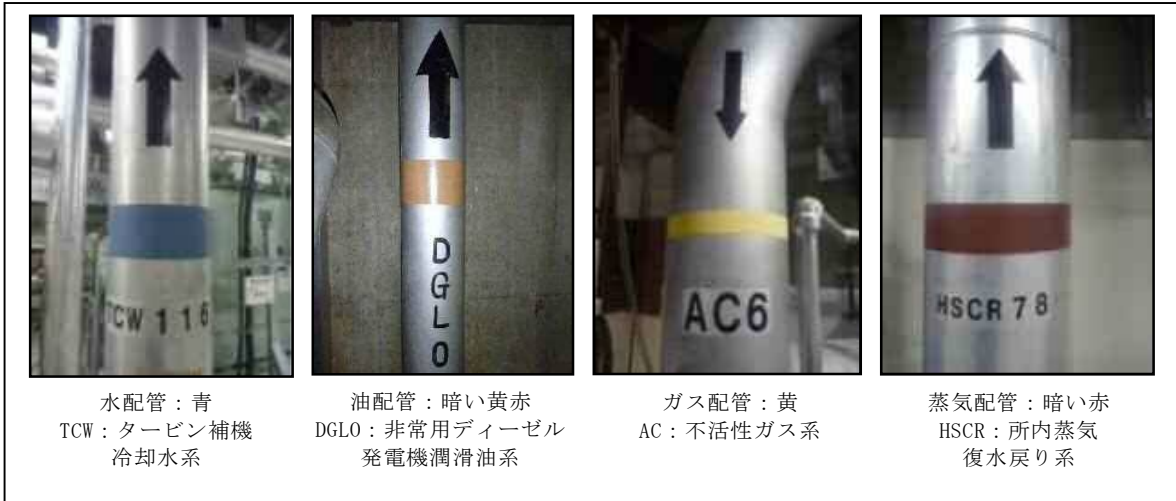
第 2.4.2-2 図 配管の識別管理（例）
