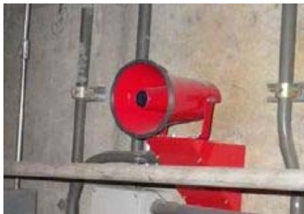
退避サイレン用音響装置
