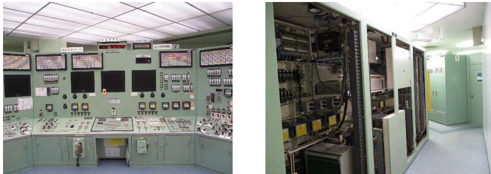
第3図 原子炉制御盤（換気口無し）
