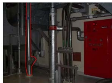
配管の設置例
