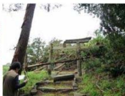
樹木の折損と鳥居の被害
