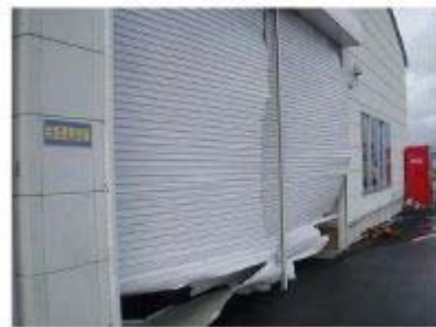
シャッターの変形
