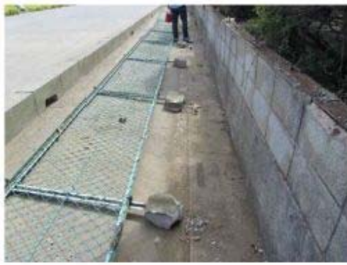
フェンスの倒壊
