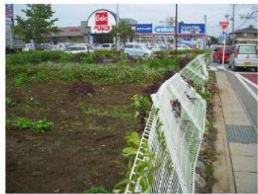
フェンスの変形
