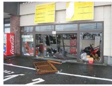
エントランスのガラス損壊
