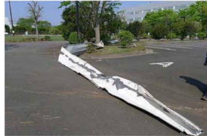
飛散した飛来物（鋼板製屋根材）
