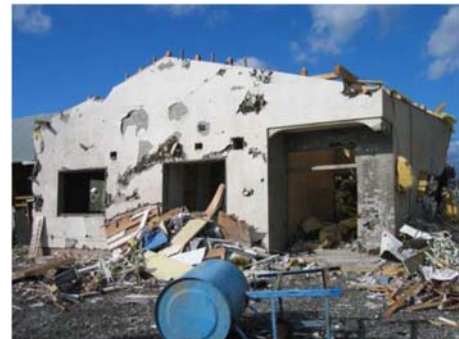
飛来物による被害を受けた建物
