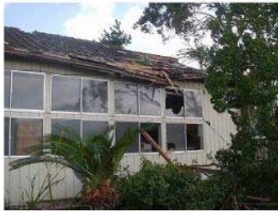
倉庫の窓ガラスと屋根の被害状況
