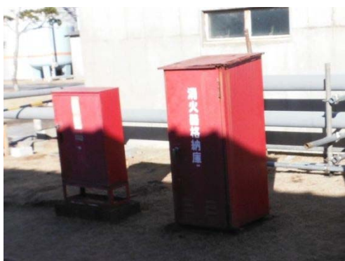
#152 消火設備格納箱
