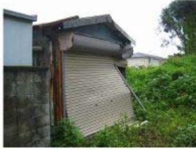
シャッターの外れ
