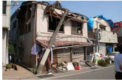
倒壊電柱に直撃された家屋
