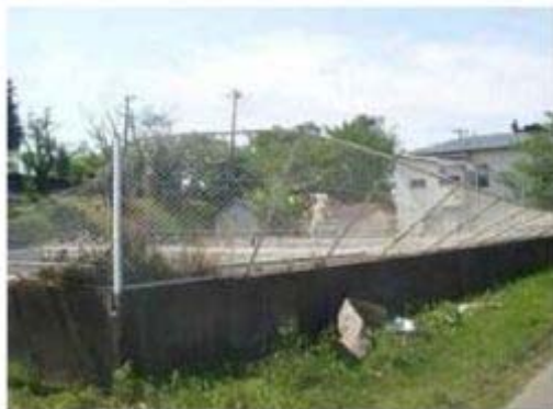
フェンスの変形
