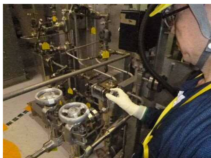
ポンプメカシールパージ流量調整操作 (原子炉冷却材浄化系ポンプメカシールパージ水ライン調整弁)
