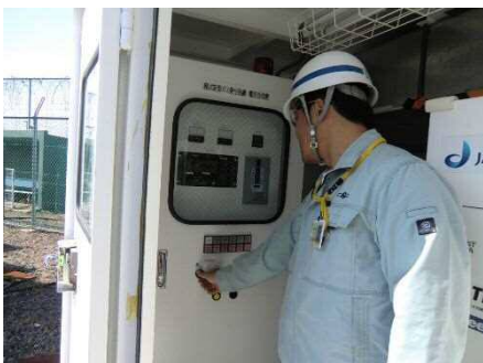
可搬型窒素供給装置（小型）起動
