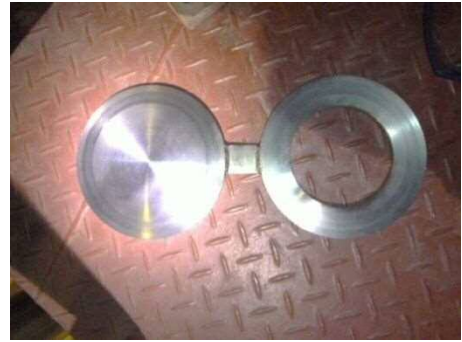
連絡配管閉止フランジ
