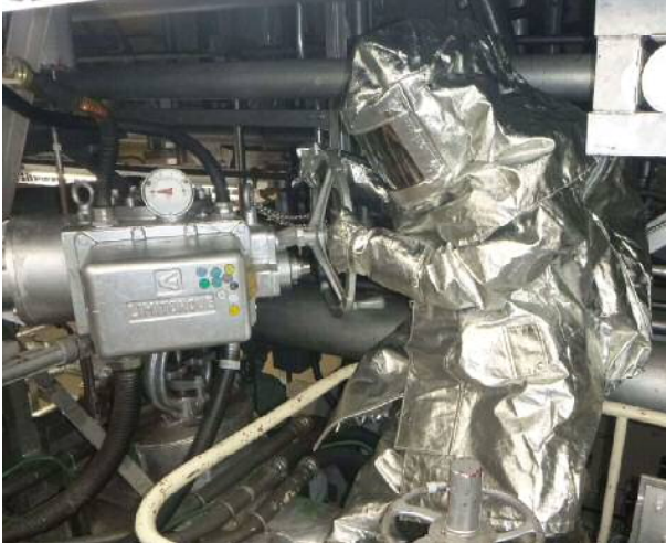
原子炉隔離時冷却系 起動操作
