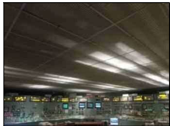
(直流非常灯点灯状態)
