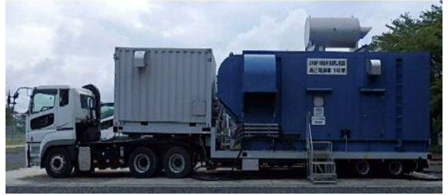
常設代替交流電源装置
