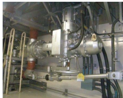
電動弁及び電線管他
