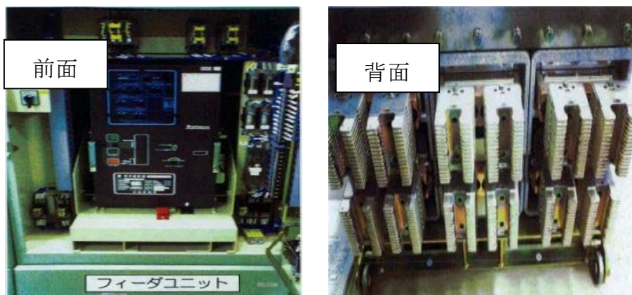
第41-1-14図 気中遮断器外観
