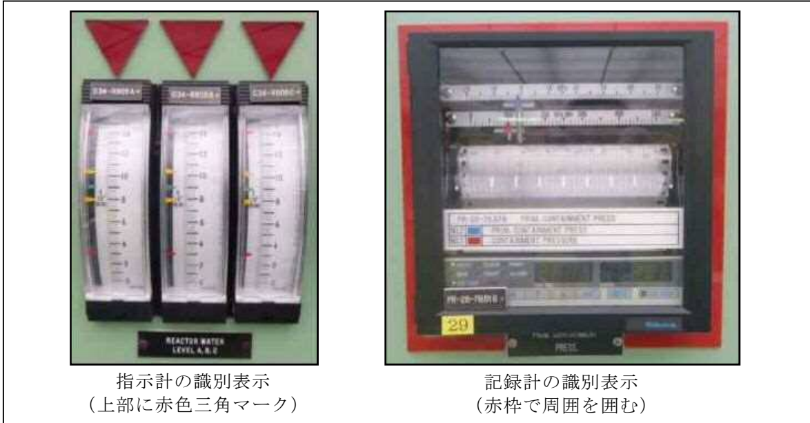
第 2.4.1-6 図 重要指示計等の識別表示（例）
