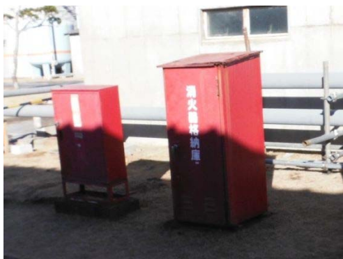
#152 消火設備格納箱
