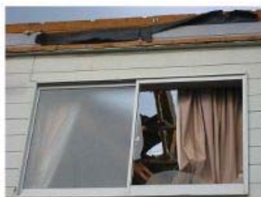
窓ガラスの損壊
