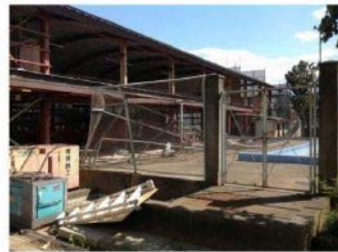
フェンスの変形（工事中の建築物）
