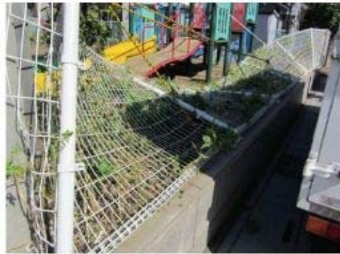
フェンスの変形
