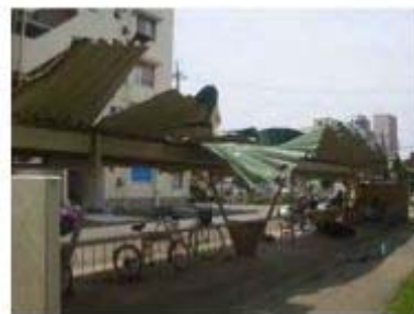
駐車場の折板屋根の著しい変形
