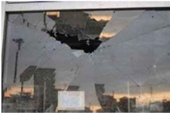
ガラスの被害状況（飛来物衝突痕）
