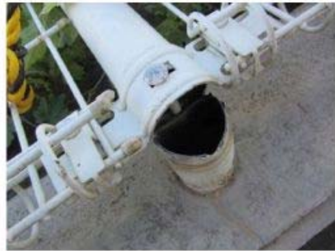
フェンス支柱部の破損
