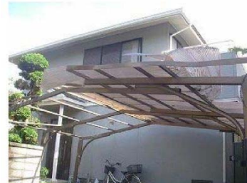
カーポートの被害
