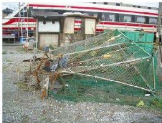
フェンスの著しい変形
