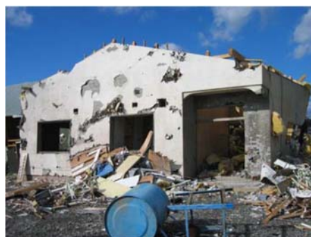
飛来物による被害を受けた建物
