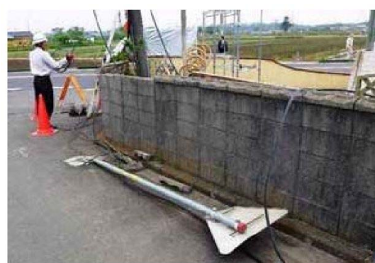
道路標識の倒壊
