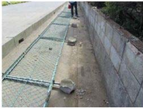
フェンスの倒壊
