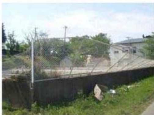
フェンスの変形
