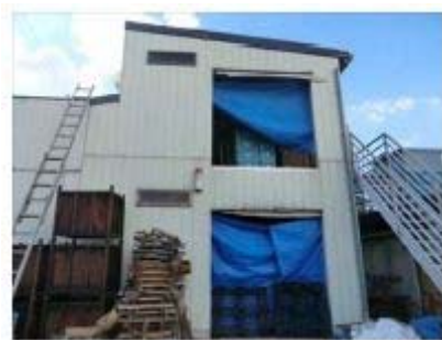
シャッターの外れ
