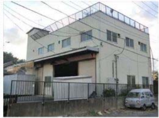
屋上フェンスの変形
