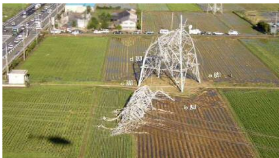
強風による送電鉄塔の倒壊事例①※ 1
