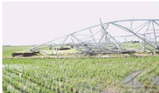
強風による送電鉄塔の倒壊事例②※ 1
