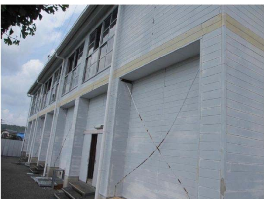
筋かい材の変形
