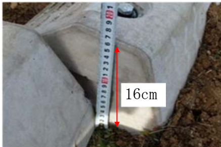
【段差復旧検証用段差】
