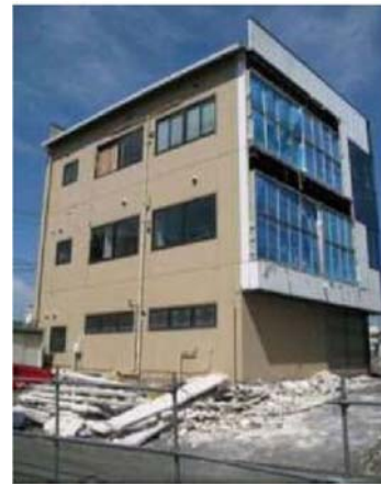
ALC パネルの脱落
