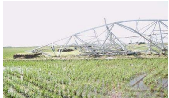
強風による鉄塔の倒壊事例② ※1
