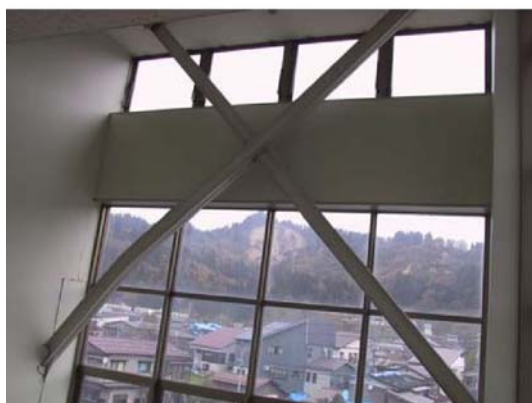
ブレース材の座屈
