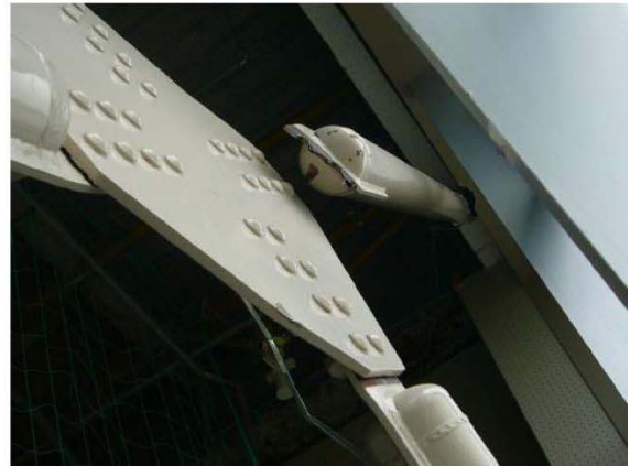
筋かい材プレート破断
