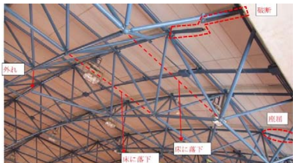
筋かい材の座屈・落下
