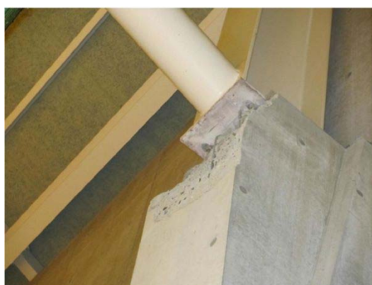
支承部コンクリート側方破壊
