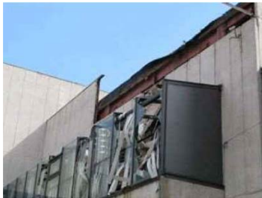
外装材の脱落，ガラス破損
