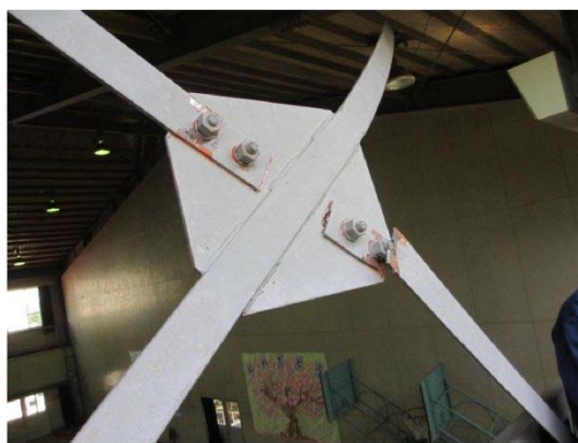
ブレース孔欠損部の破断
