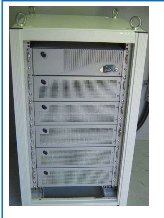
無停電電源装置
