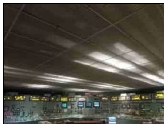
（直流非常灯点灯状態）
