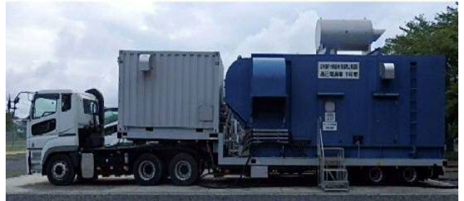
常設代替交流電源装置
