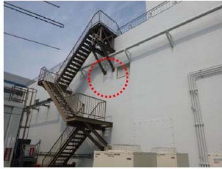
図2 外気取入口（中央制御室換気空調系）
