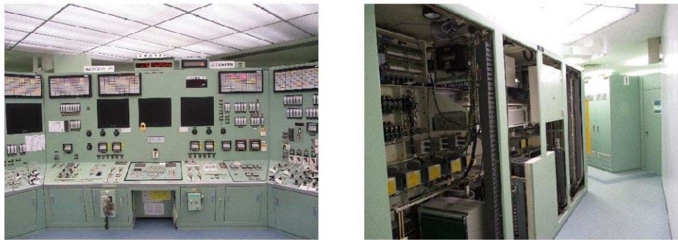
図3 原子炉制御盤（換気口無し）
