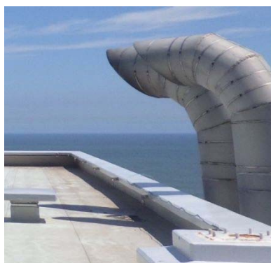
図 2-6 ディーゼル発電機 排気管
