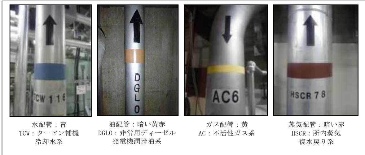
第 2.4.2-2 図 配管の識別管理（例）
