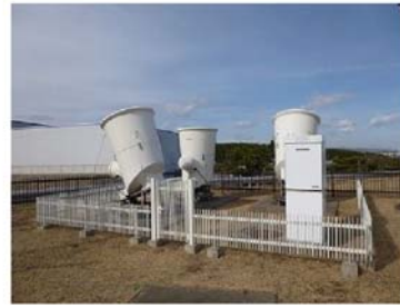
【ドップラーソーダ (風向風速計)】 (排気筒高さ)
