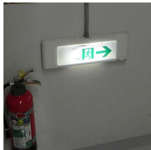
通路誘導灯（廊下・通路）
