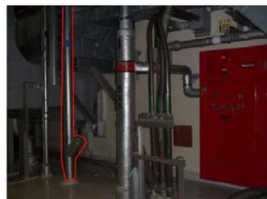
配管の設置例
