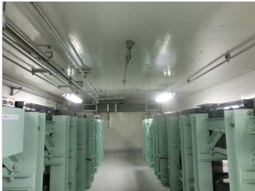
第 1-43 図 蓄電池の設置状況
