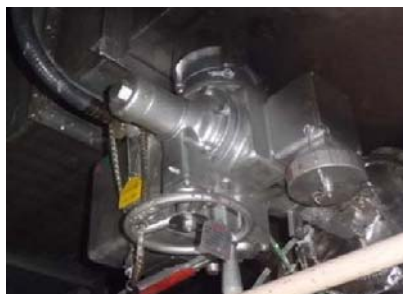
通路上部の電動弁
