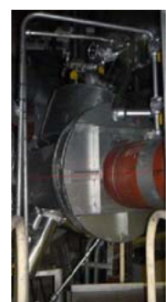
通路上部の電動弁
