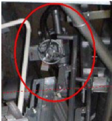
通路上部の電動弁，電線管他
