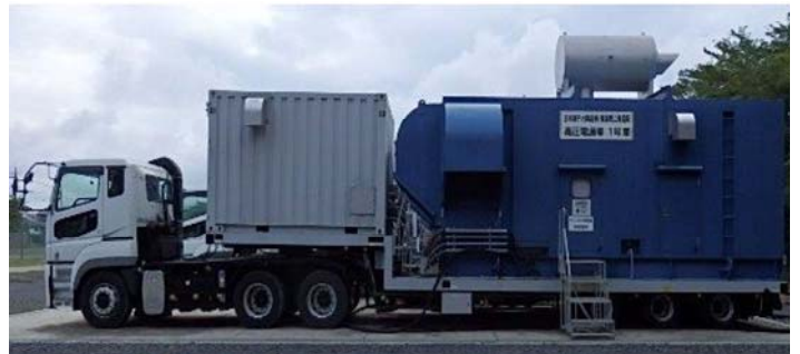
常設代替交流電源装置
