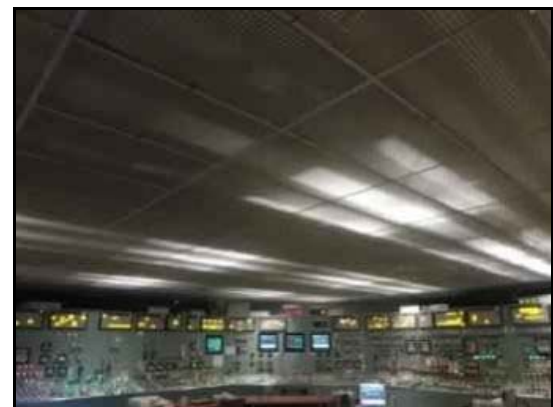
（直流非常灯点灯状態）
