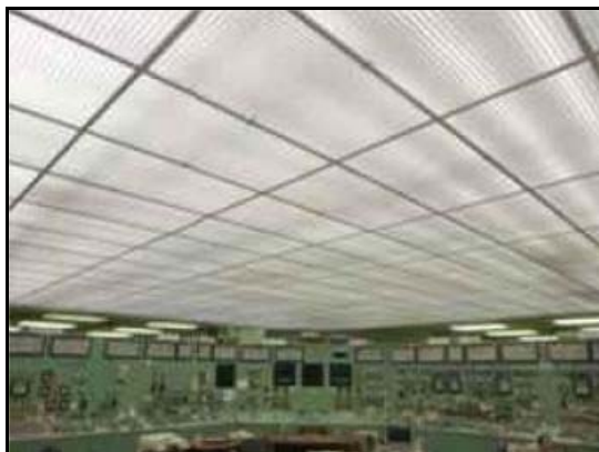
（通常点灯状態）
