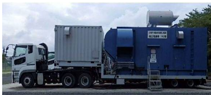
常設代替交流電源設備
