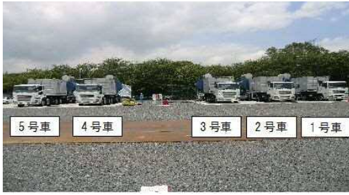
常設代替高圧電源装置 (イメージ)
