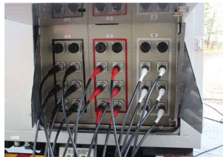
低圧ケーブル接続箇所（可搬型代替低圧電源車）
