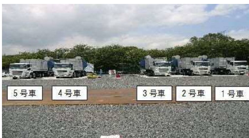
常設代替高圧電源装置（イメージ）
