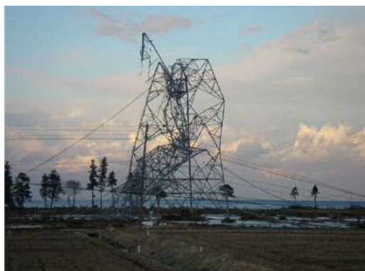
津波による隣接鉄塔の倒壊に伴う送電鉄塔の倒壊事例※ 2
