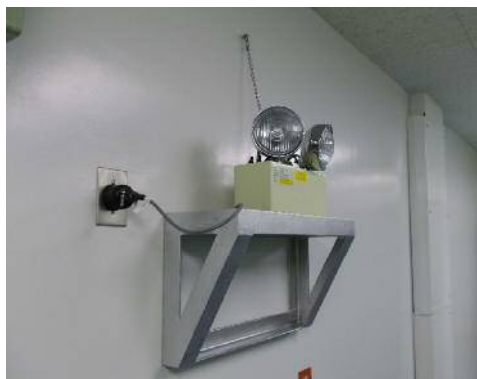
第 1.0.13-6 図 蓄電池内蔵型照明の例
