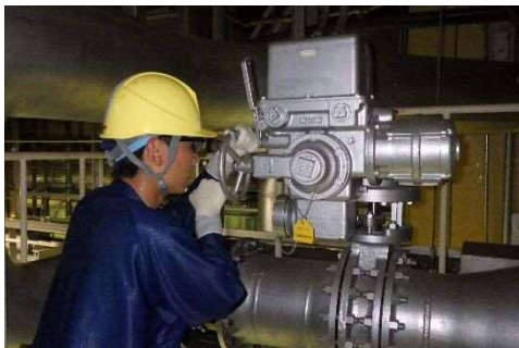
耐圧強化ベント現場操作
