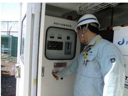
可搬型窒素供給装置（小型）起動
