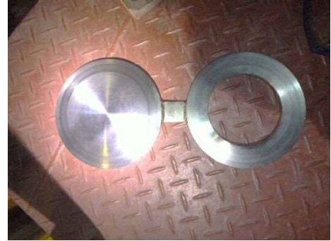
連絡配管閉止フランジ
