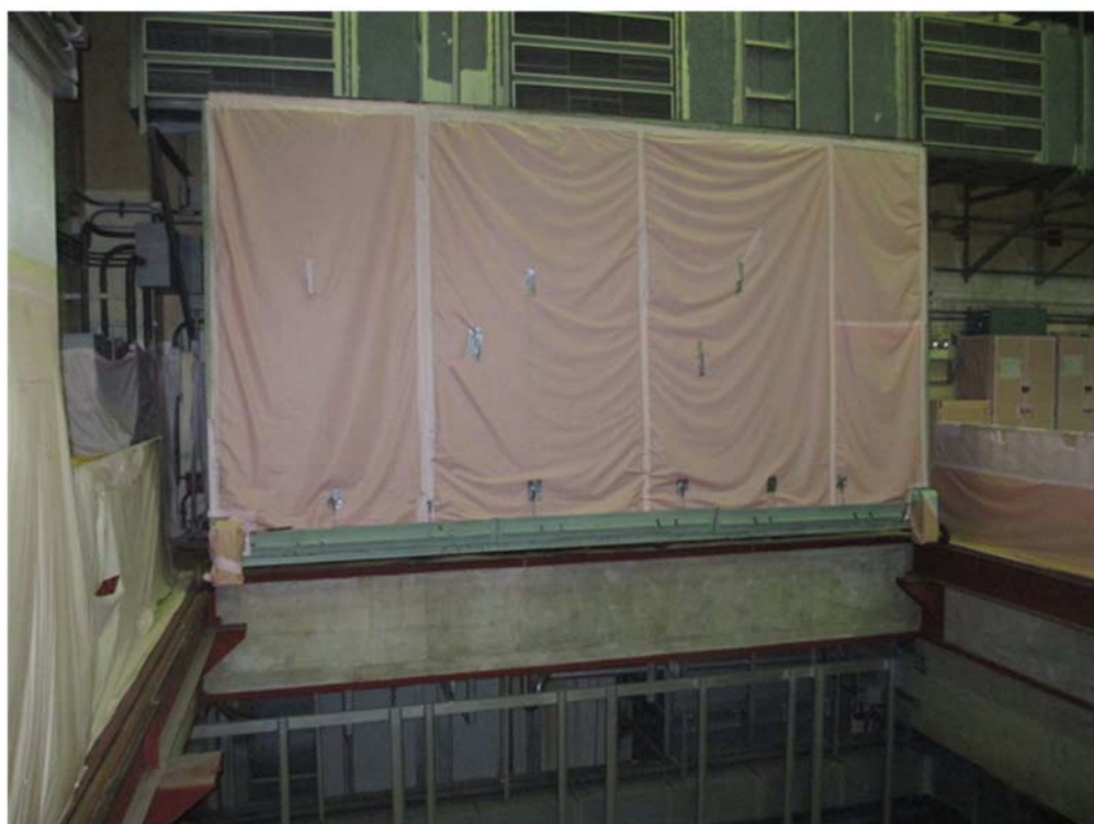
第2図 大物搬入口ハッチの開状態
