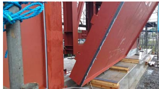
パネル開放状況(パネル下部)
