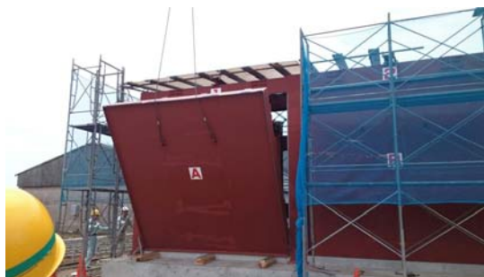
パネル開放状況
